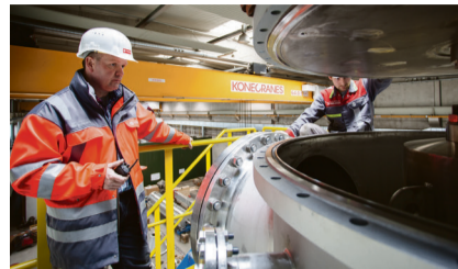
Vertikaler Dünnschichtverdampfer im Probetrieb Test run of a vertical thin-film-dryer
